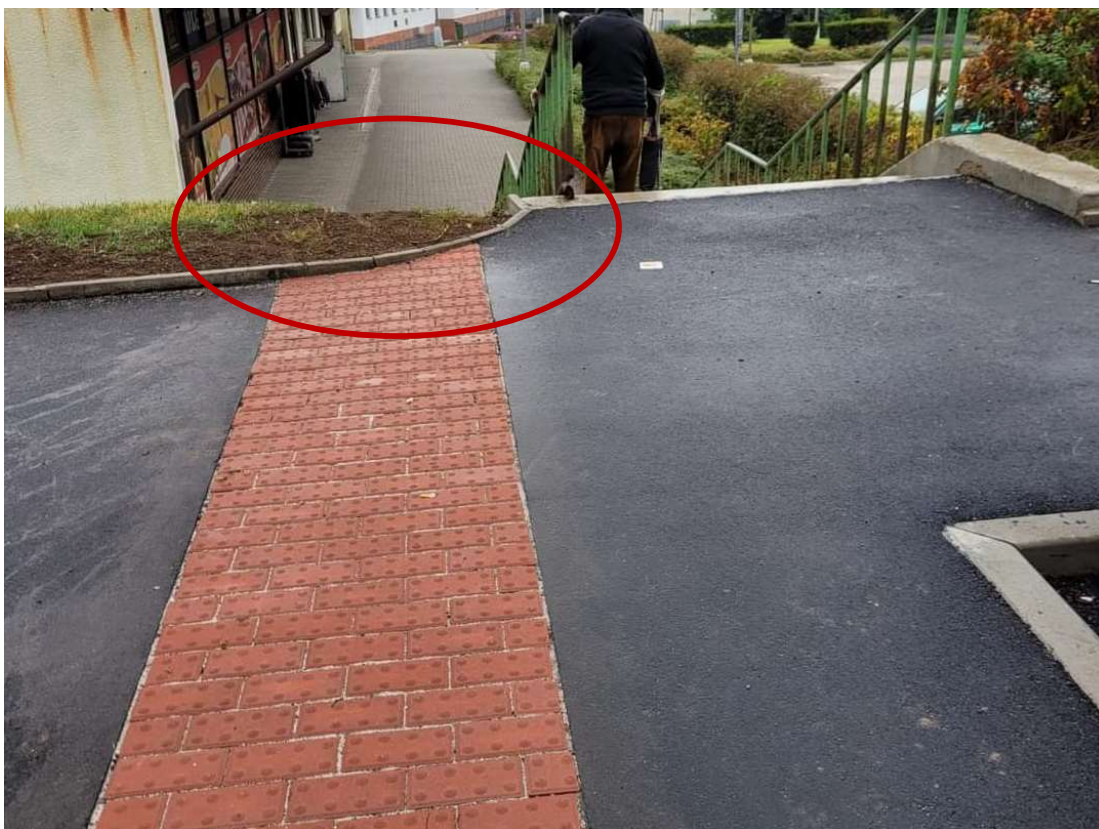
Obrázek 1 – nedostatečná výška vodící linie
