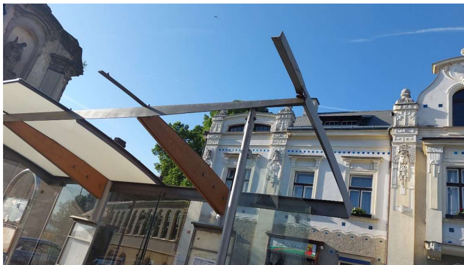
Obrázek 2 – Chybějící část přístřešku na zastávce autobusu na Klášterním náměstí
